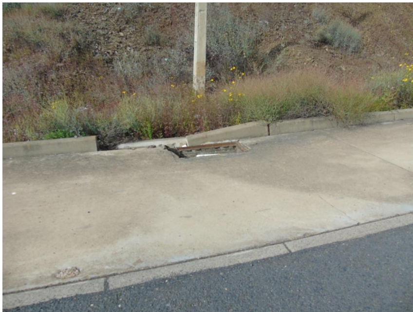
Calle Gonzalo de Berceo. Bordillos de aceras rotos y falta de tapas de alcantarillas.
