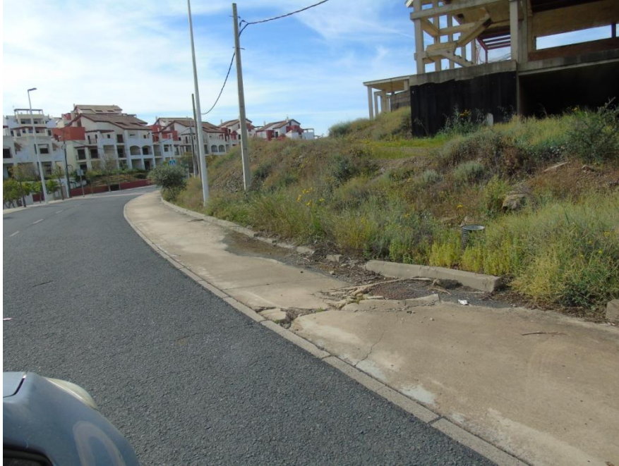
Calle Gonzalo de Berceo. Destrucción parcial del parte del acerado.
